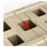
Узкое отверстие на стыке каналов
