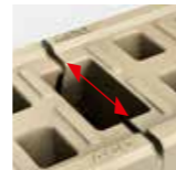
Широкое отверстие на стыке каналов
