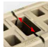
Широкое отверстие на стыке каналов
